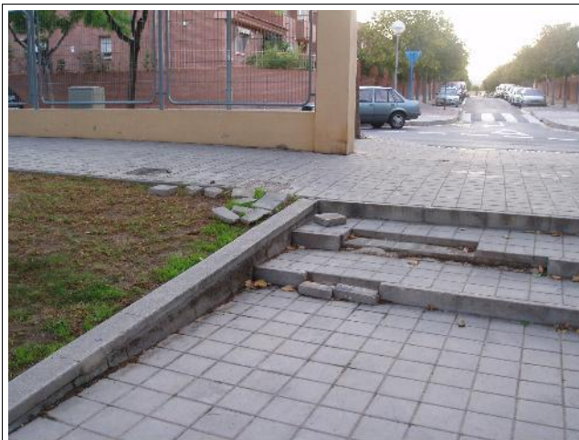
Losetas levantadas en el acceso al parque
